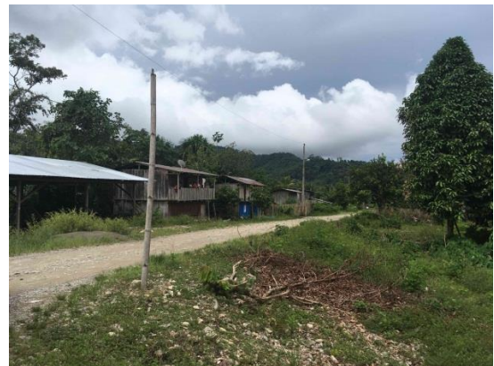
Red de Servicio Eléctrico
