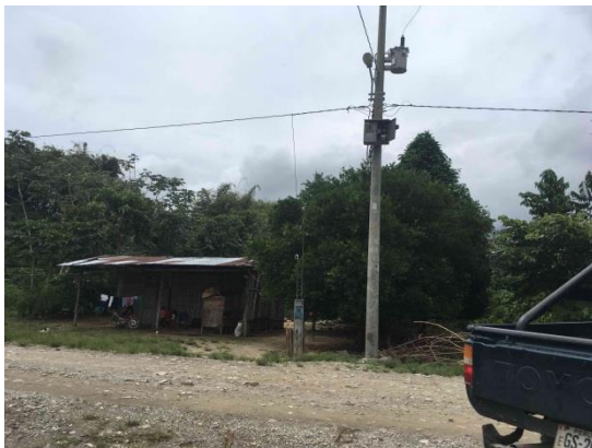
Red de Servicio Eléctrico
