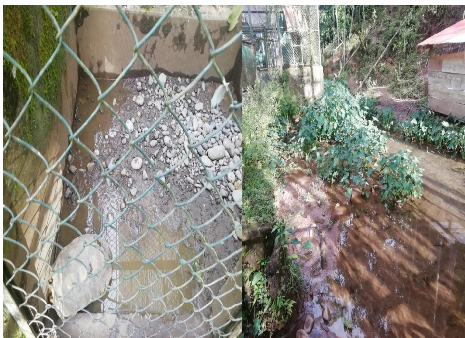
Figura 68. Presencia de aguas estancadas
