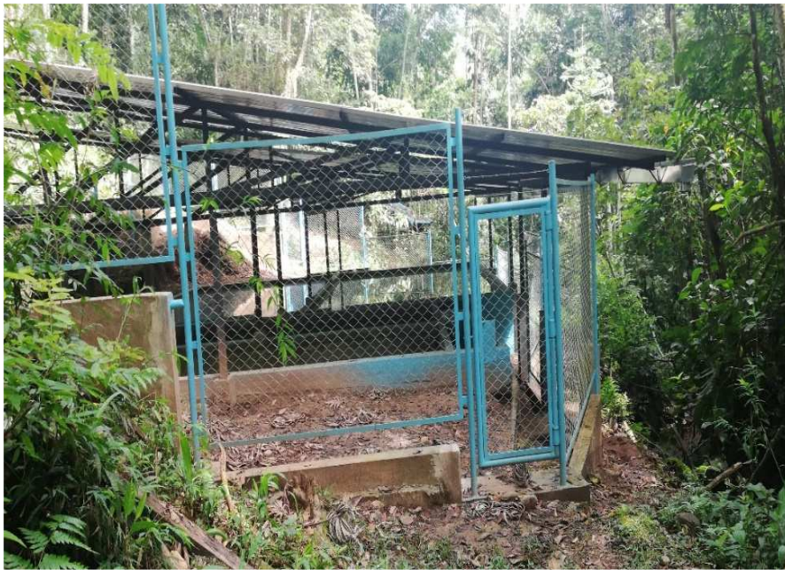
Figura 112. Sistema de agua potable (desarenador, sedimentador, filtro y reservorio) de la quebrada Naranjal.
