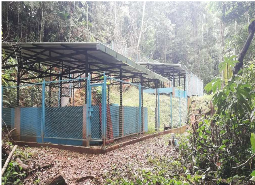
Figura 114. Sistema de agua potable (desarenador, sedimentador, filtro y reservorio) de la quebrada Córdoba.
