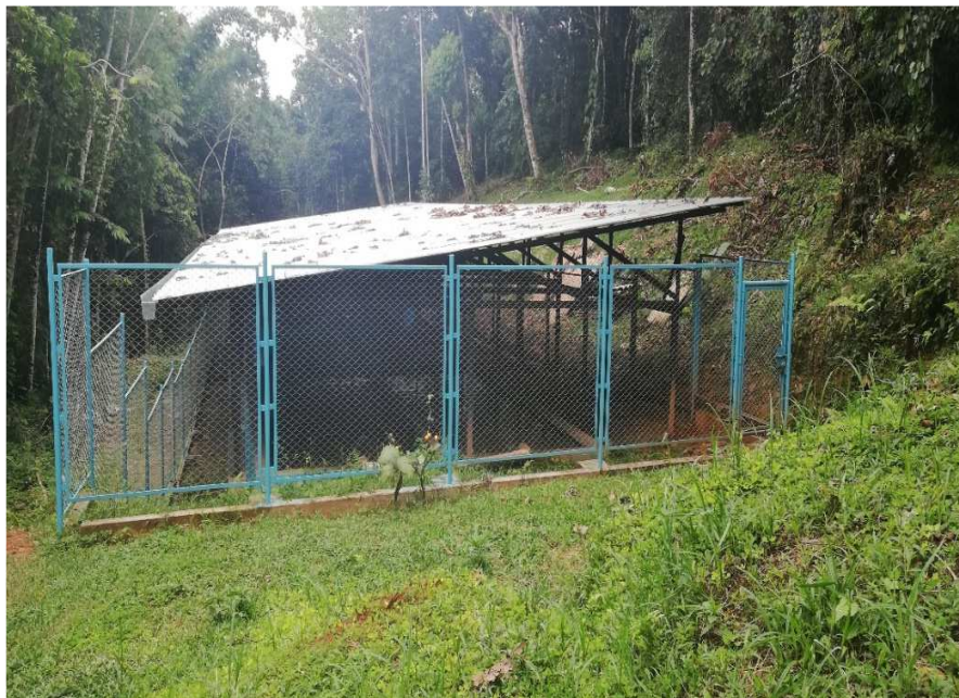
Figura 116. Sistema de agua potable (desarenador, sedimentador, filtro y reservorio) de la quebrada Cochero.
