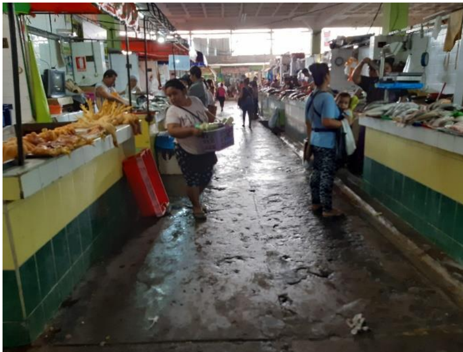
Figura 56. Pescado fresco y aves beneficiadas, nótese en deterioro del piso
