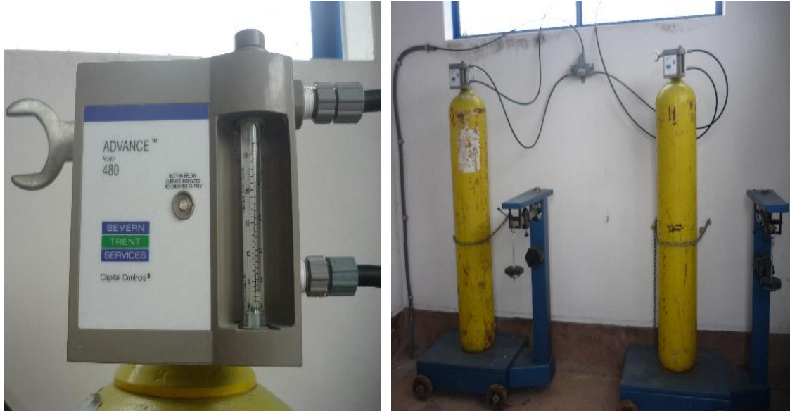
Figura 25. Etapa de desinfección del agua mediante aplicación de cloro gas por inyección al vacío.
