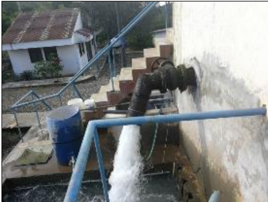
Figura 7. Se aprecia la mezcla de agua cruda con agua tratada.
