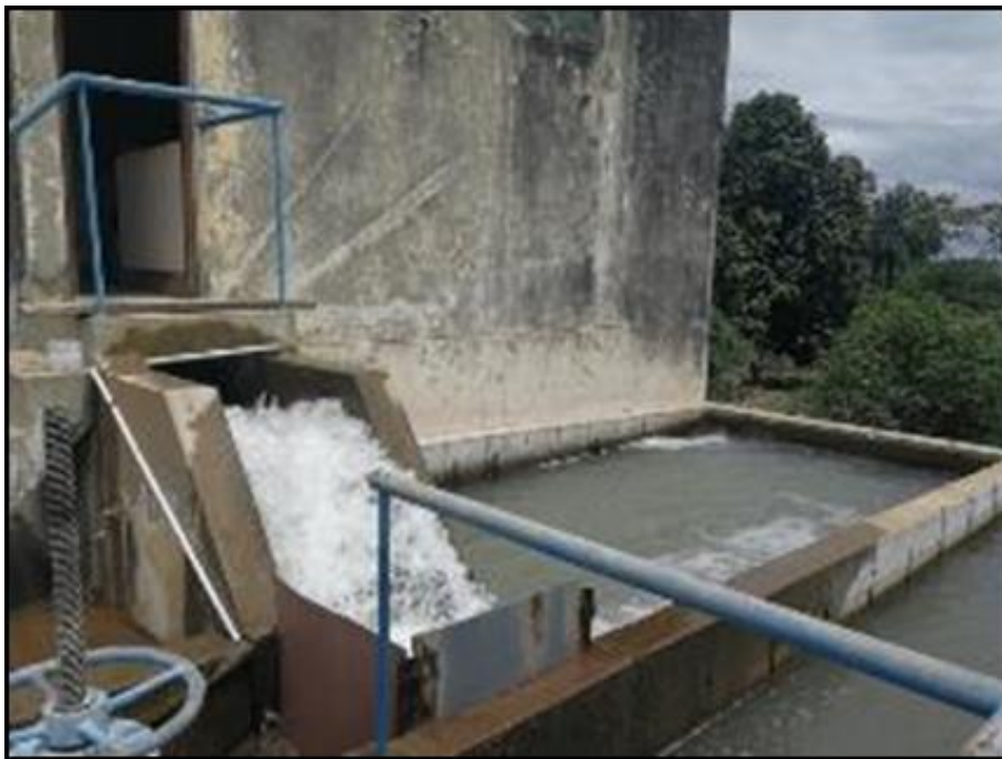
Figura 6. Zona de ingreso a la mezcla rápida.
