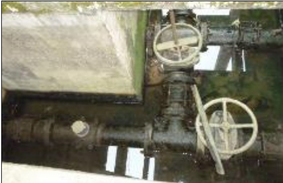
Figura 10. Se aprecia que la válvula está oxidada.
