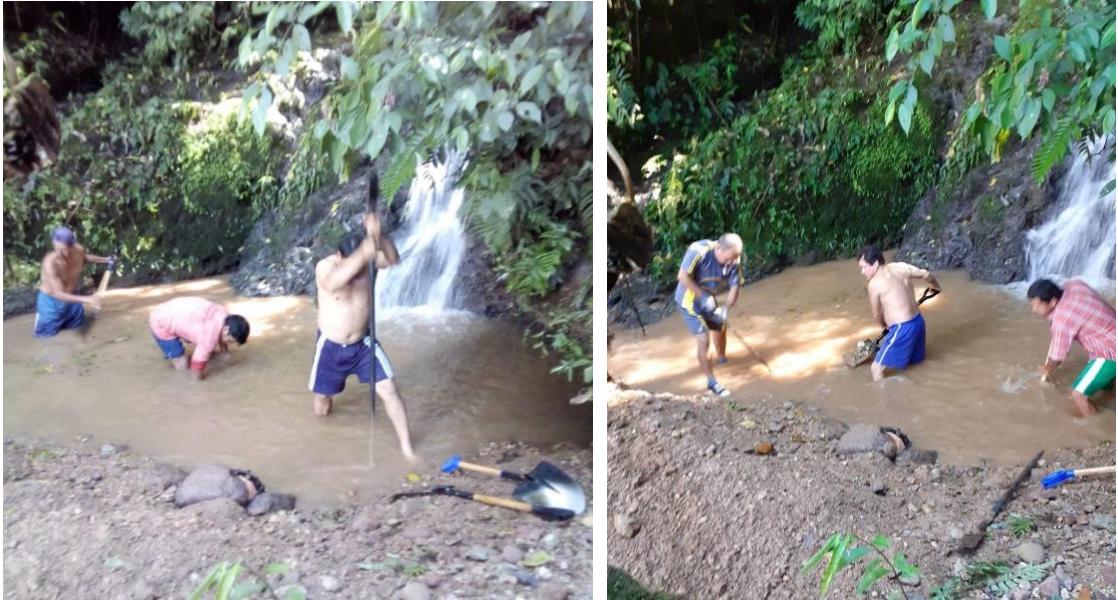
Figura 36. Trabajos de descolmatación de la captación de emergencia, con esto se pretende mantener la presión y cantidad de volumen de agua hacia el desarenador.
