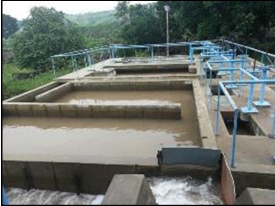
Figura 5. Vista panorámica del floclador, no se aprecian las pantallas.
