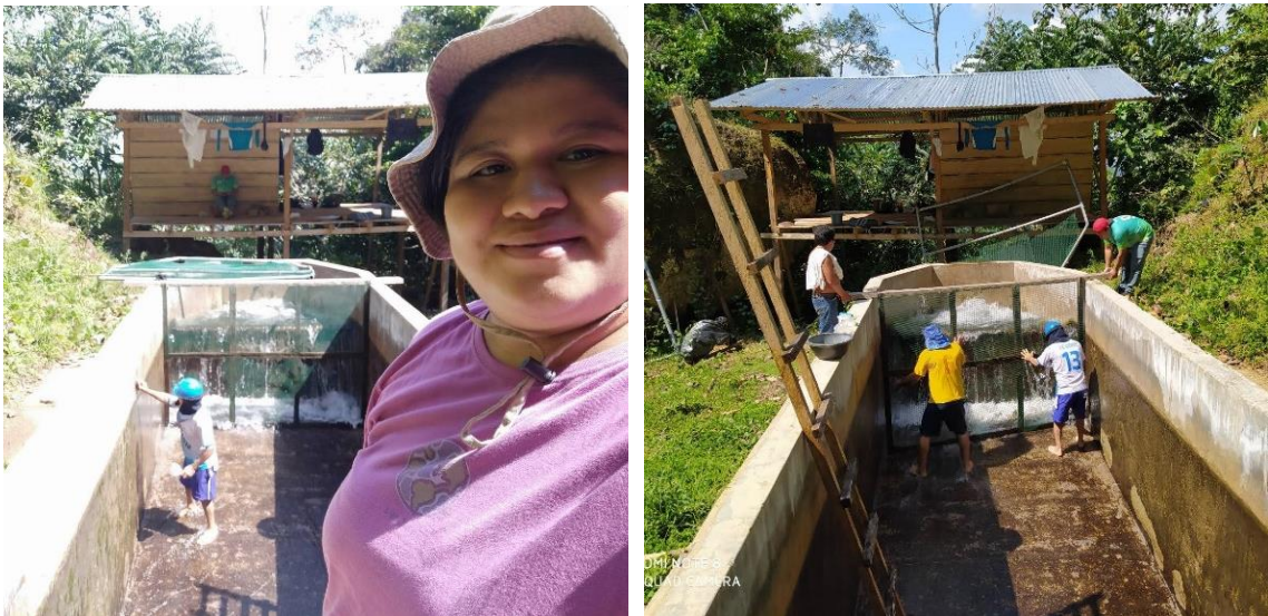
Figura 37. Mejoramiento de la caseta de pernoctación del operador de captación, renovación de la malla del desarenador para no permitir el ingreso de hojas, ramas u otros residuos a la línea de conducción.
