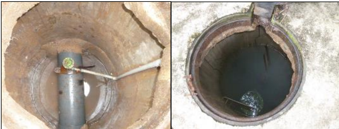
Figura 9. Abrazaderas oxidadas y con agua en el fondo de la cámara (A) y la cámara totalmente inundada y apreciarse la válvula (B).
