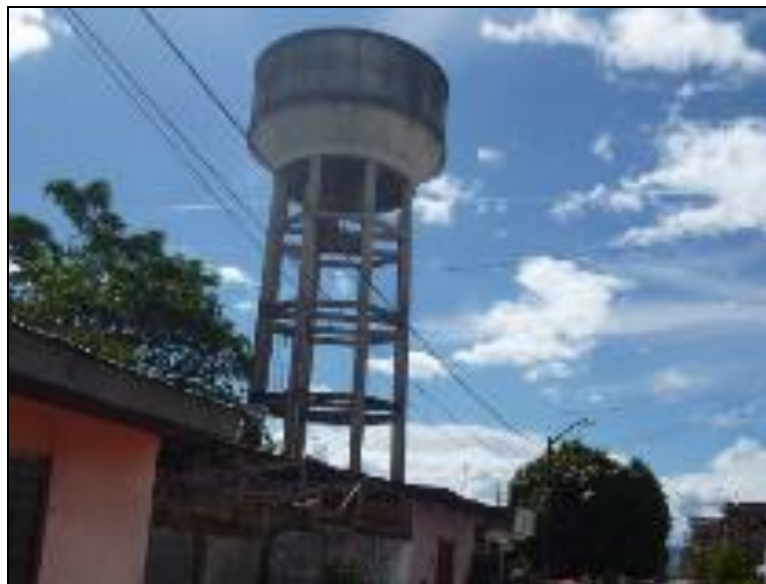
Figura 11. Reservorio de 150 m 3 .
