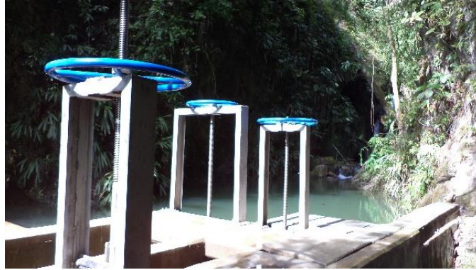
Figura 14. Vista de compuertas tipo tarjeta de acero inoxidable en captación de agua.
