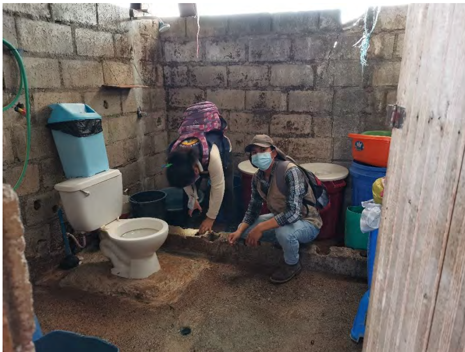
Figura 35. Inspección de ladrillos con agua acumulada de una vivienda del Sector VI.
