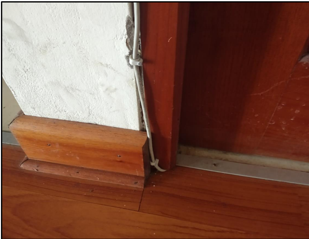
Figura 27. Cableado del Auditorio Fuente: Elaboración Propia
