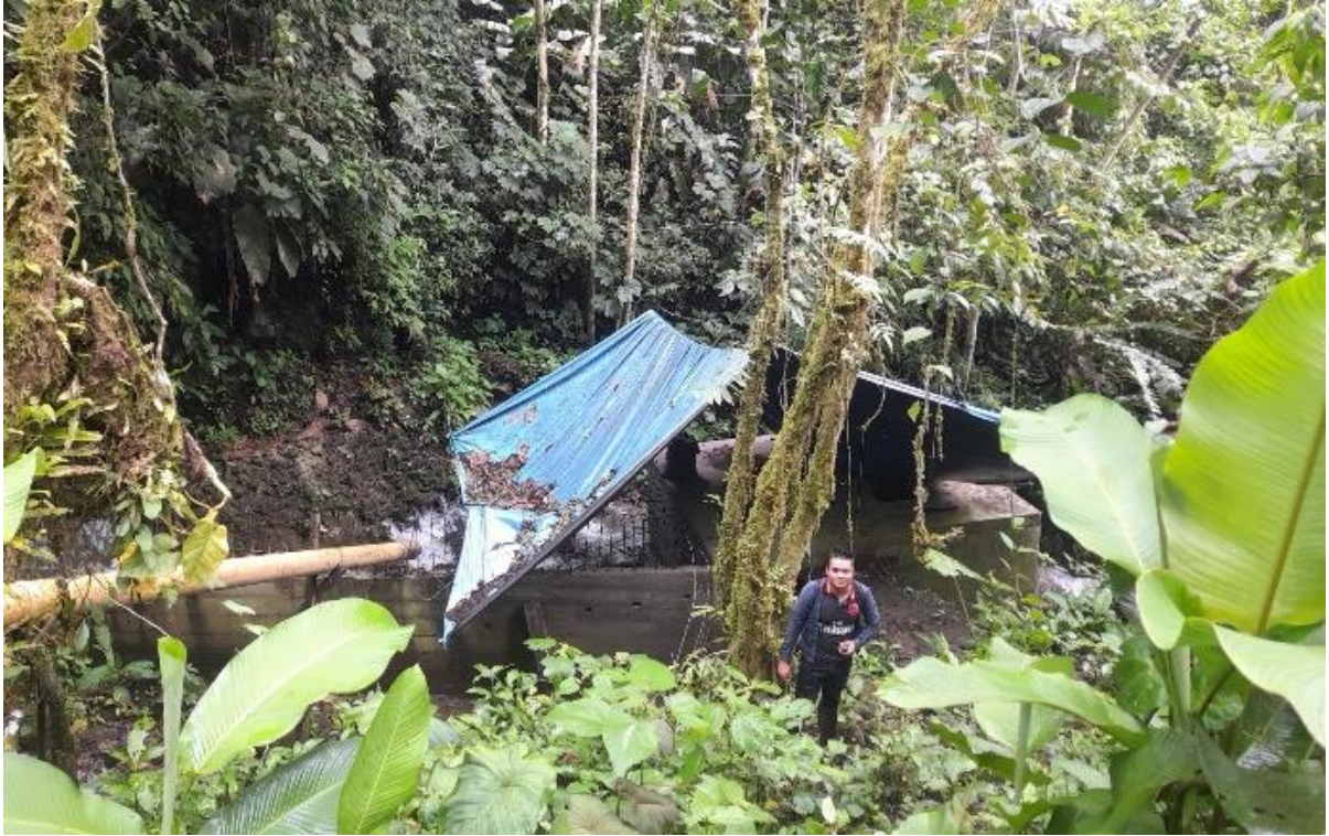
Figura 11. Captación La Tablilla.
