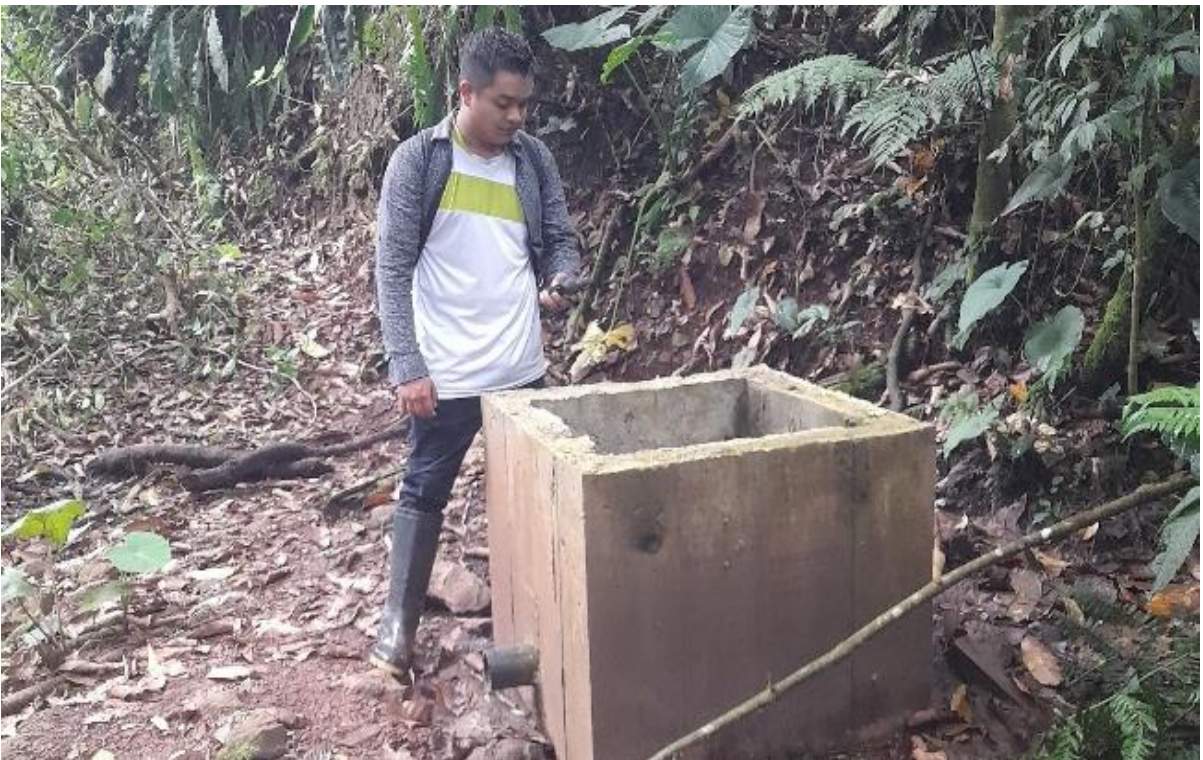
Figura 16. Cámara rompe presión
