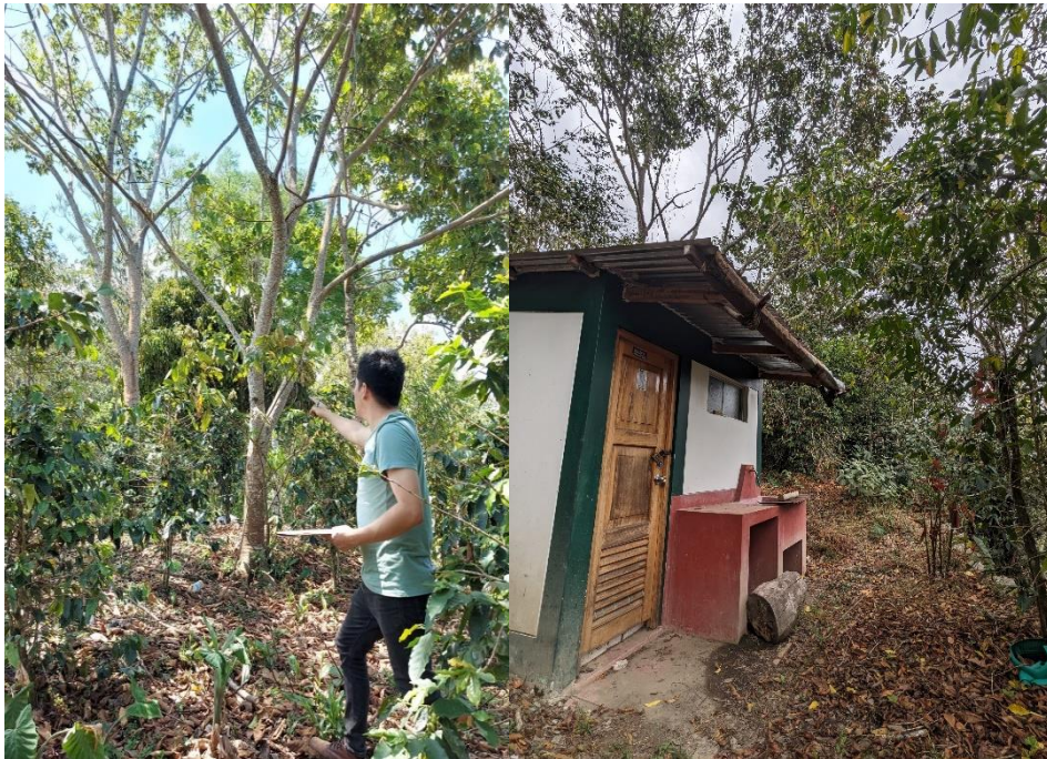
Figura 46. Verificación in situ de especies arbóreas e instalación de letrinas en fincas cafetaleras de la microcuenca Sacsara.
