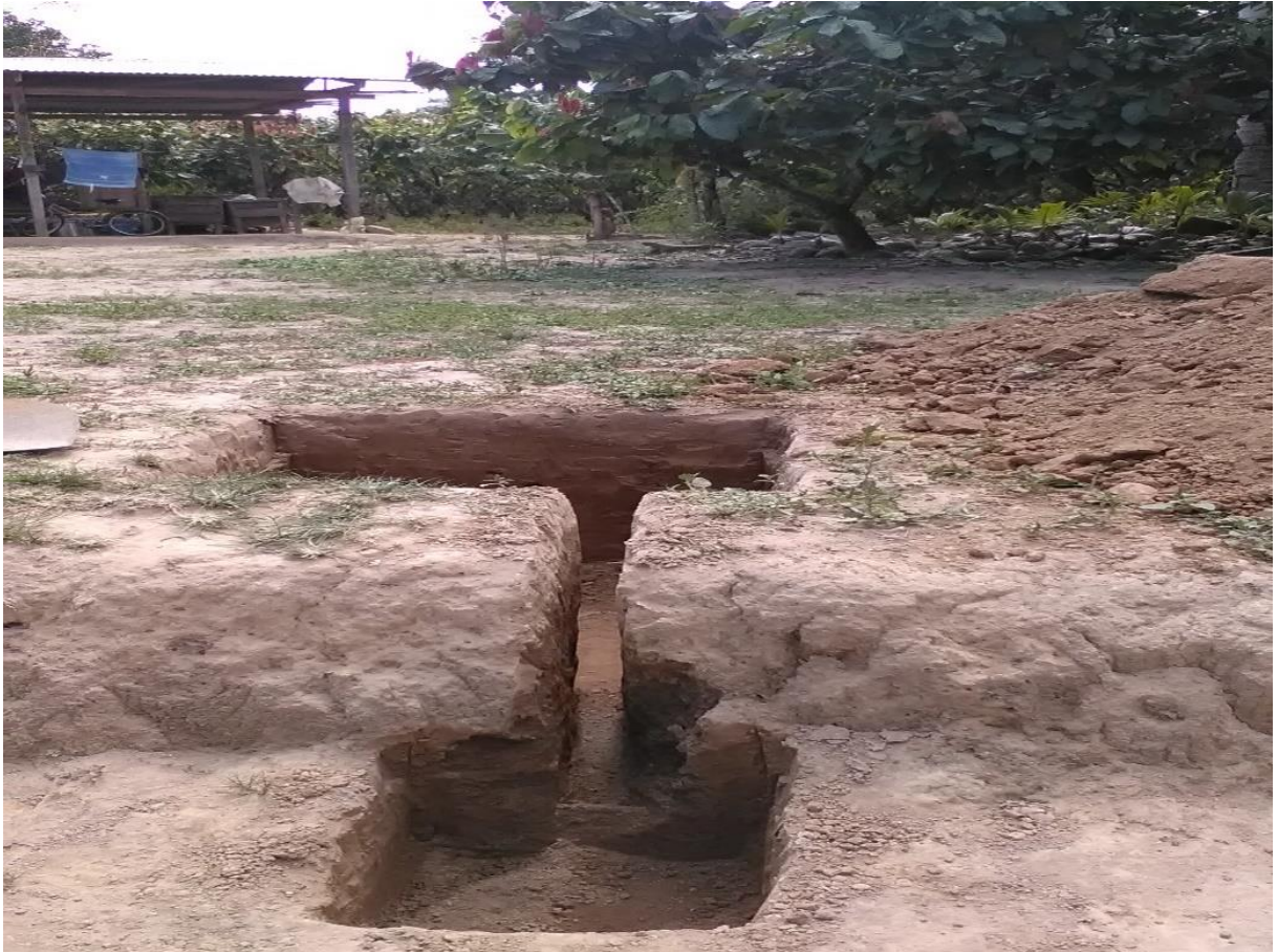
Figura 15. Excavación para la colocación de la maceta y el recipiente de almacenamiento de agua drenada.
