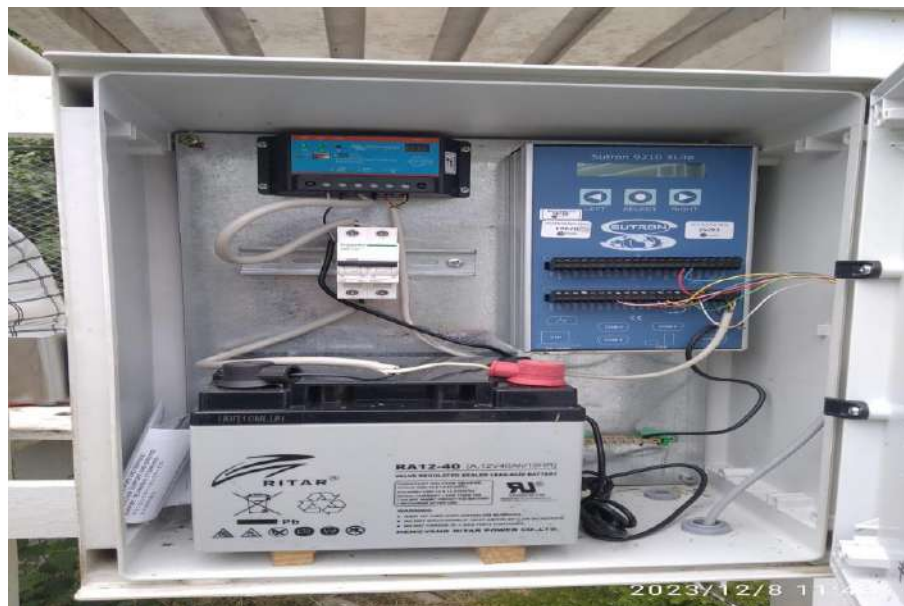
Figura 36. Equipo automático medidor de las variables meteorológicas.
