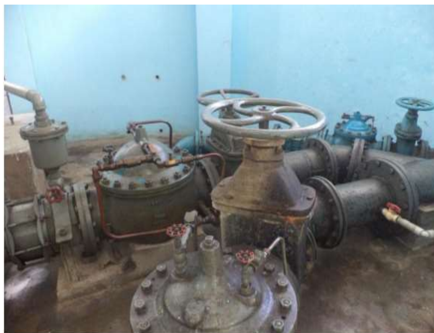
Figura 87. Instalaciones del funcionamiento de la red hidráulica.
