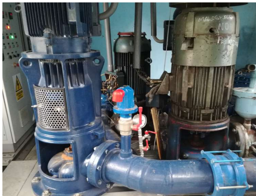
Figura 86. Instalaciones del funcionamiento de las electrobombas.
