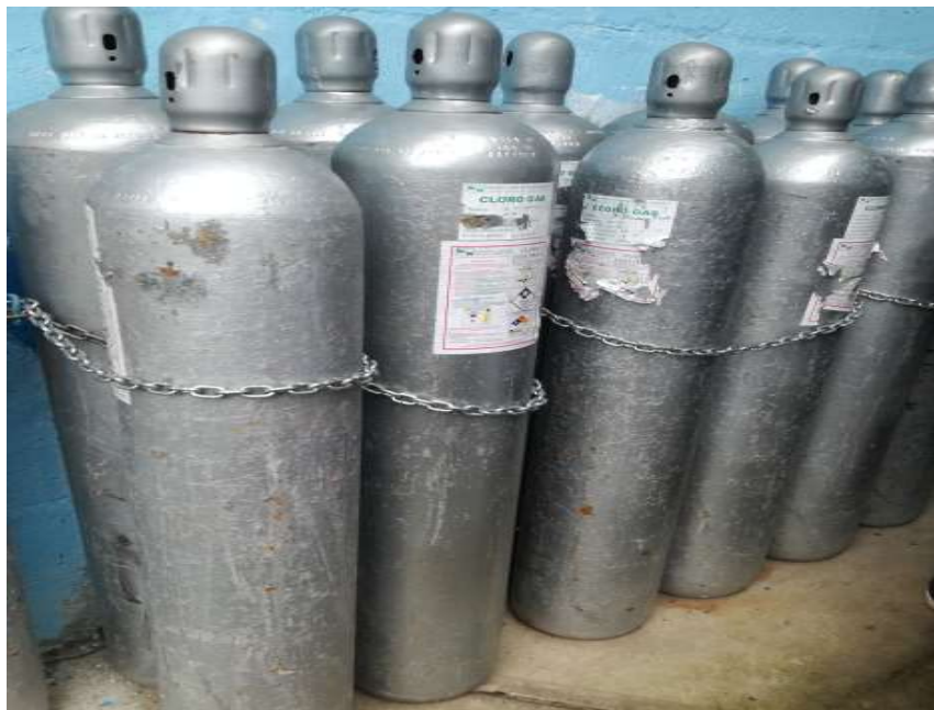
Figura 88. Almacenamiento del cloro de gas
