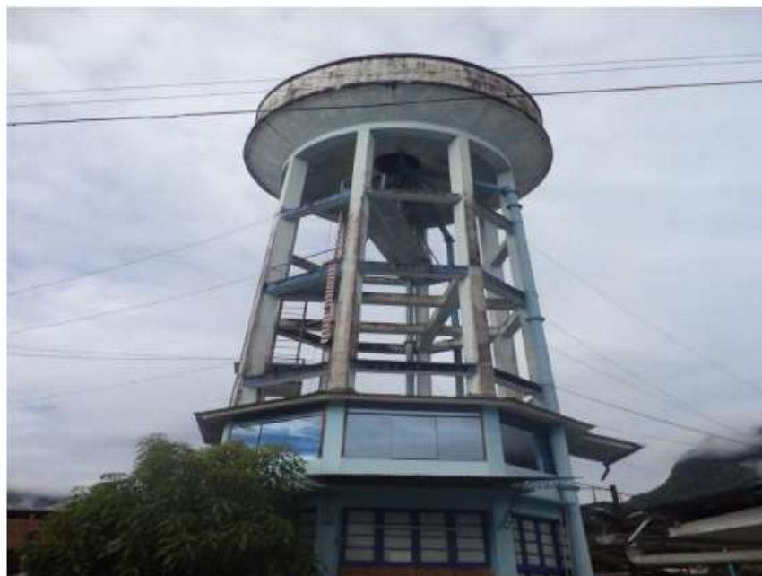
Figura 92. Reservorio de Tingo María de la zona sur con una capacidad de 200 \text{ m}^3 .
