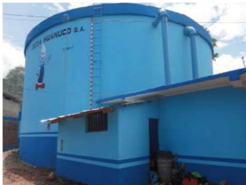
Figura 90. Reservorio de Tingo María de la zona urbana con una capacidad de 1800 m 3 .
