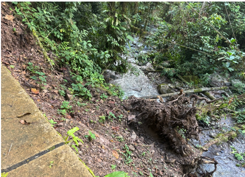
Figura 29. Inestabilidad del suelo
