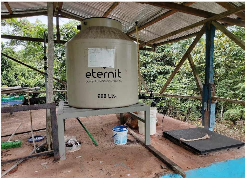
Figura 20. Tanque clorador del sistema de abastecimiento de agua potable.
