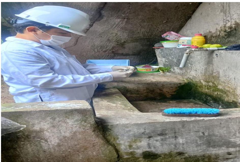
Figura 7. Conexión domiciliaria con presencia de mohos.
