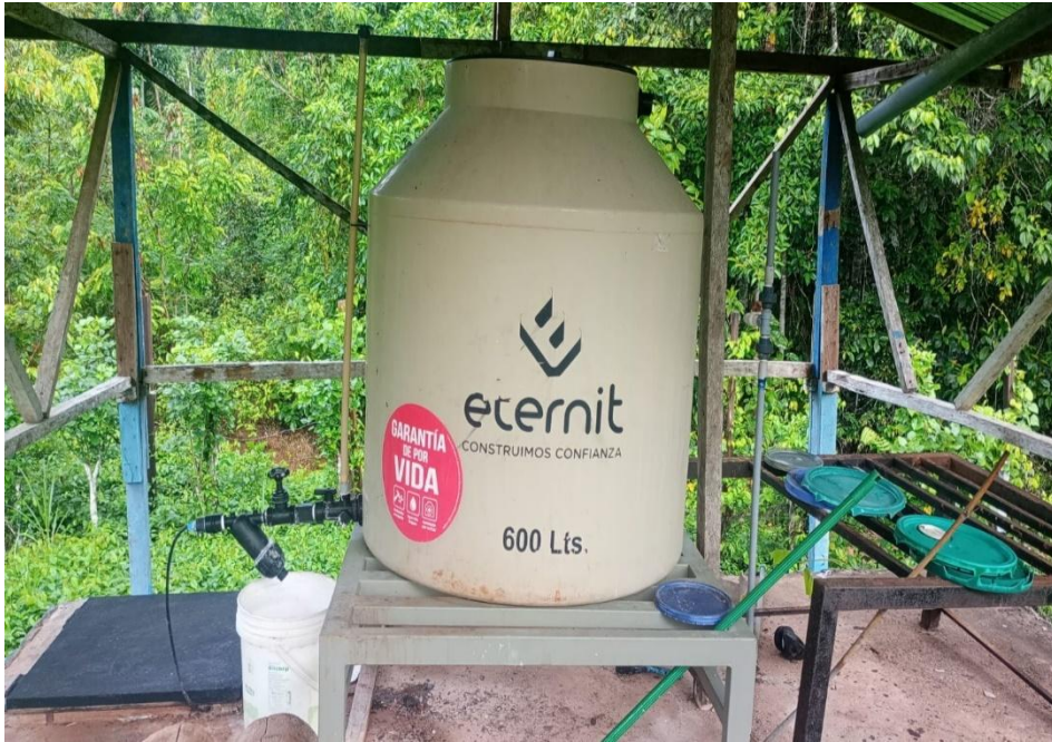
Figura 6. Tanque clorador en buen estado.
