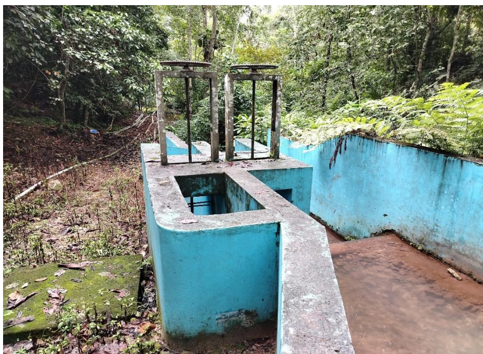
Figura 2. Captación con presencia de malezas, hojarasca, mohos y algas.
