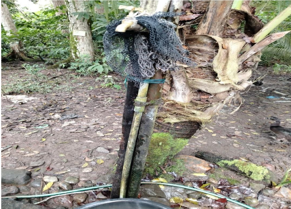
Figura 23. Conexión domiciliaria del sistema de abastecimiento de agua potable.
