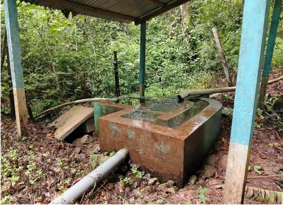
Figura 3. Desarenador con presencia de suciedad y moho.
