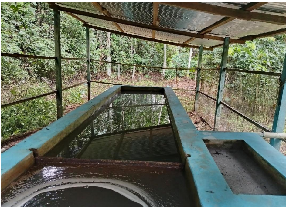
Figura 4. Sedimentador con presencia de suciedad.
