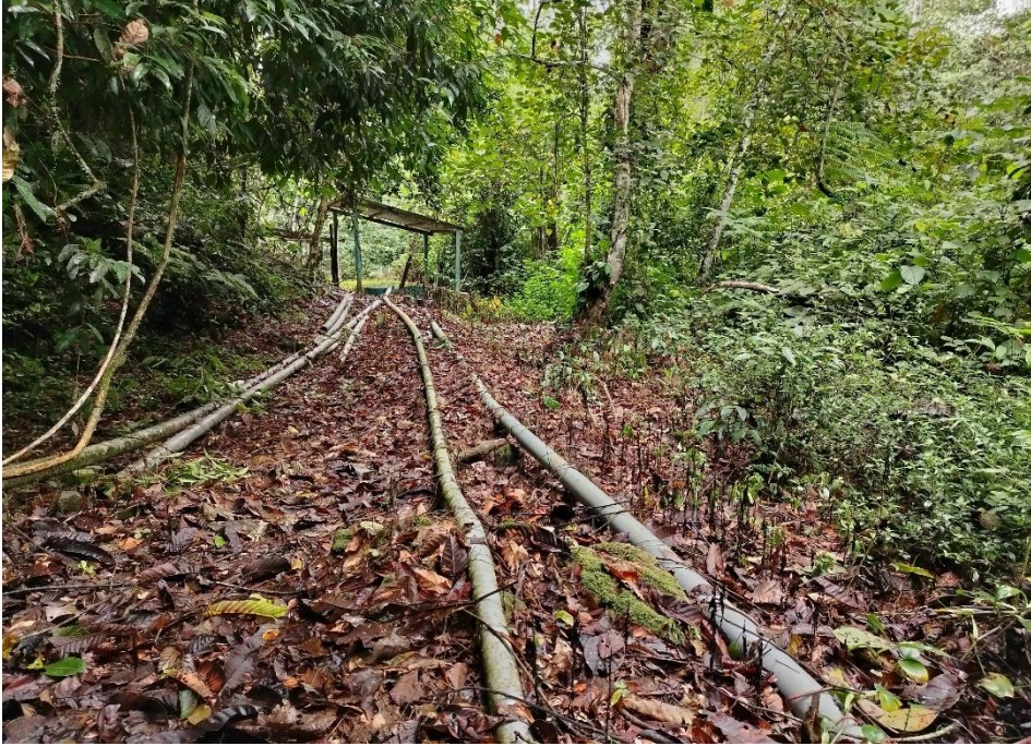
Figura 21. Tuberías del sistema de abastecimiento de agua potable.
