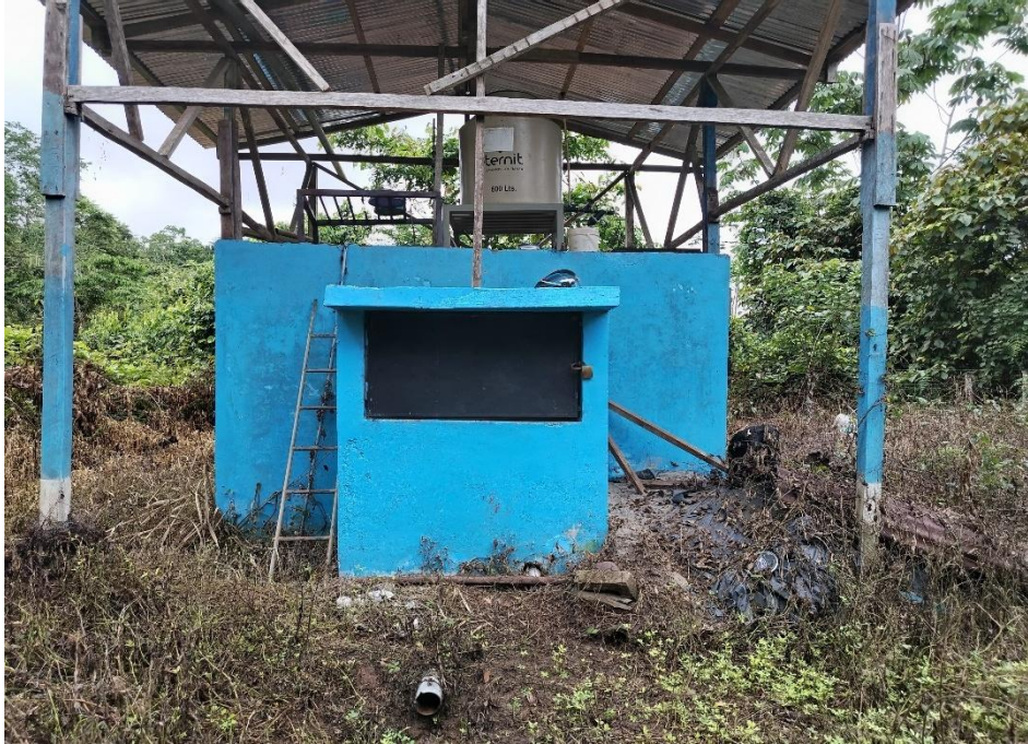
Figura 5. Reservorio con presencia de malezas en su entorno.
