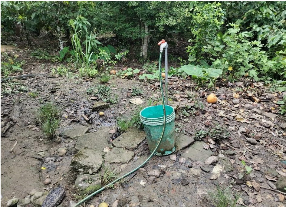
Figura 22. Conexión domiciliaria del sistema de abastecimiento de agua potable.
