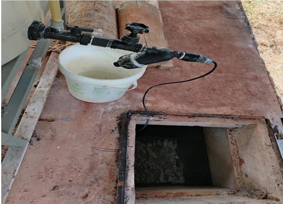
Figura 43. Sistema de cloración por goteo.
