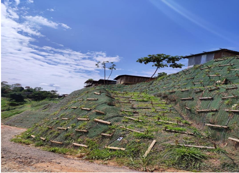
Figura 12. Casas en peligro de hundimiento por estar cerca al área de deslizamiento de tierras.
