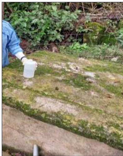
Figura 2. Tapa deteriorada de la estructura de captación de agua de manantial Shalla
