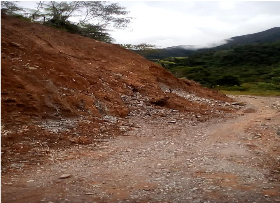
Figura 34. Zona con presencia de erosión
