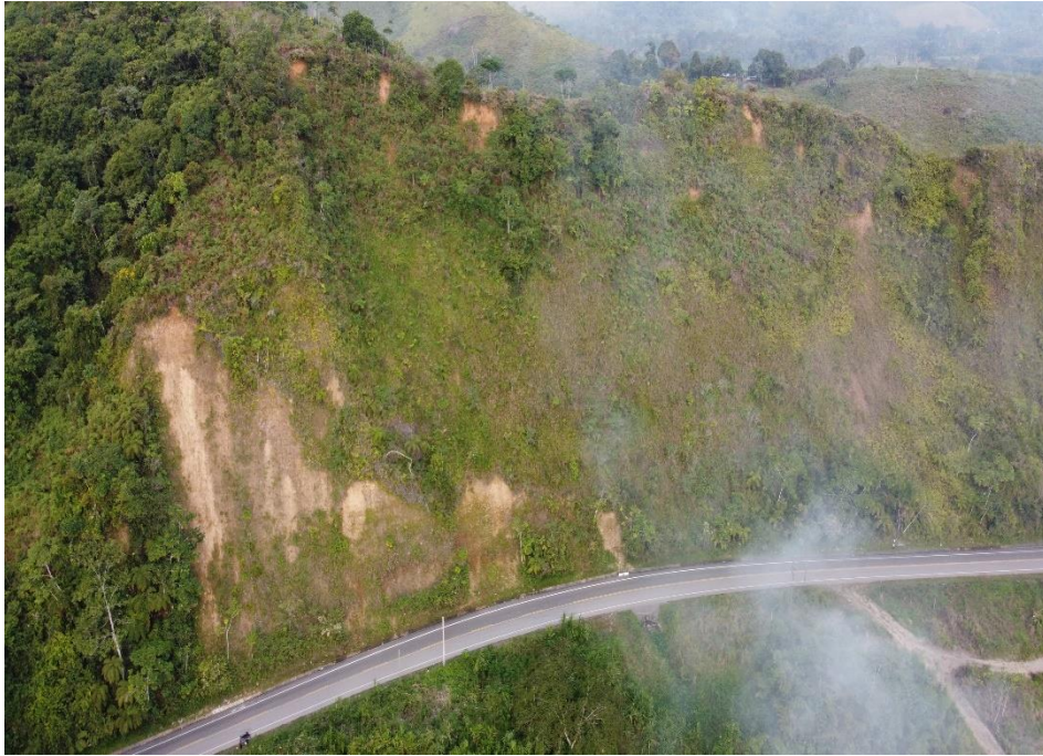
Figura 37. Deslizamiento en la localidad Peregrinos, tramo Tingo María - Aucayacu, ocurrido en la fecha 1/03/2017.
