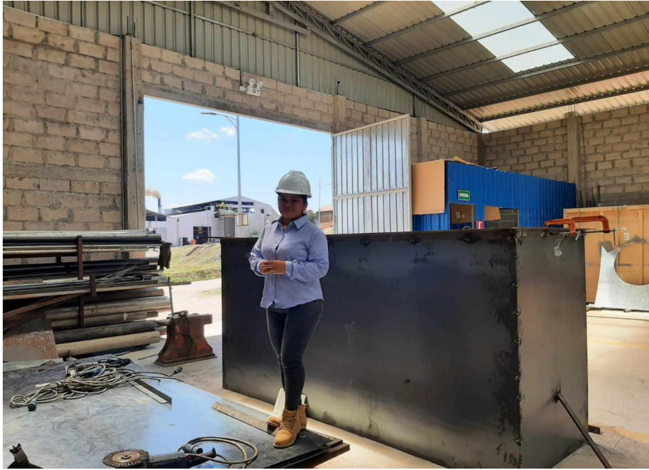
Figura 36. Parte de la estructura del decantador tipo florentino
