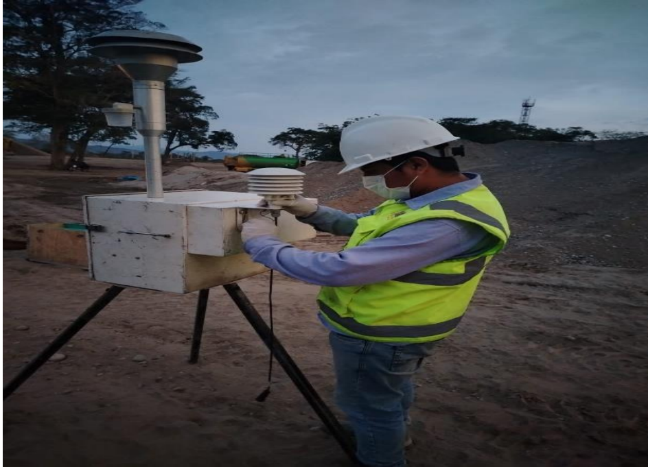
Figura 14. Instalación del Tecora para la medición del material particulado PM_{10} en la planta de concreto
