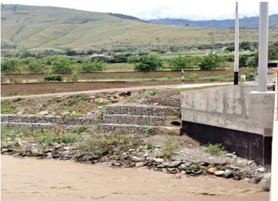
Figura 86. Punto de vertimiento.
