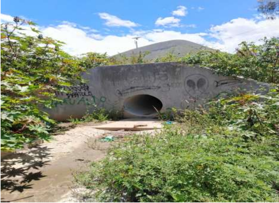
Figura 91. Punto de vertimiento.
