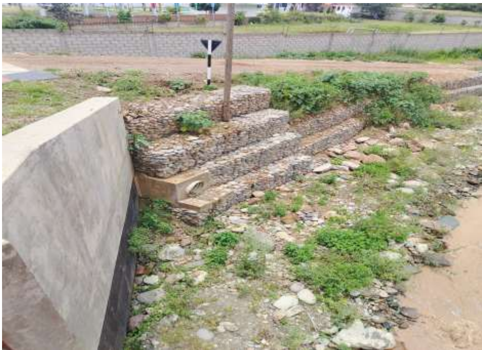
Figura 88. Punto de vertimiento.
