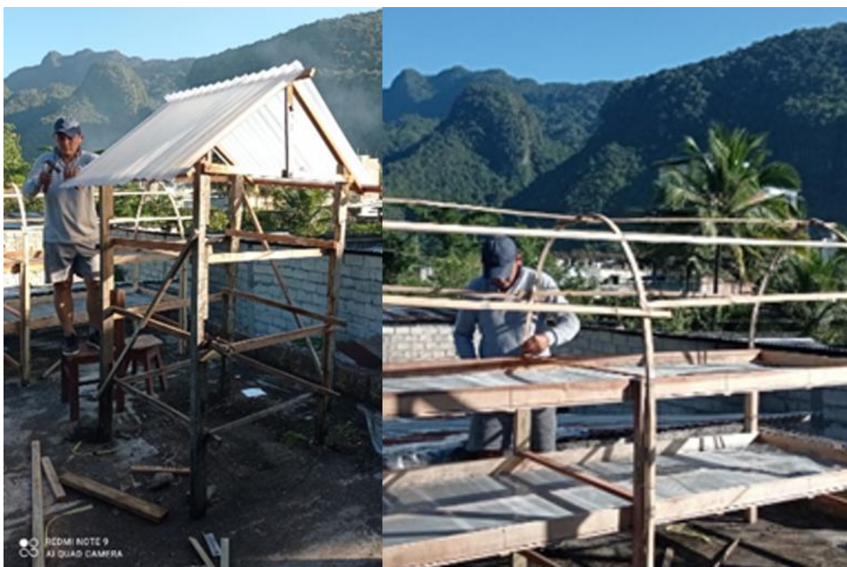
Figura 15, Habilitación de tarimas con techo de calamina transparente y secador solar,
