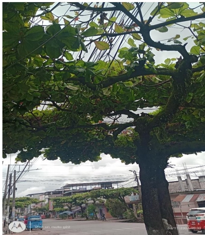
Figura 28. Árbol en contacto con cables eléctricos
