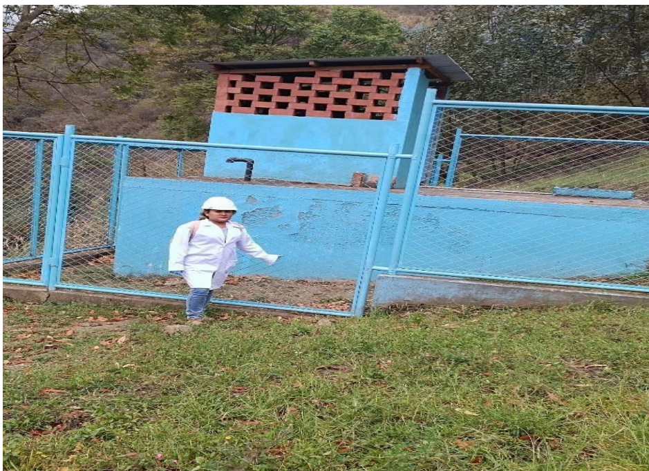
Figura 28. Reservorio de agua CC.PP San Pablo de Lanjas
