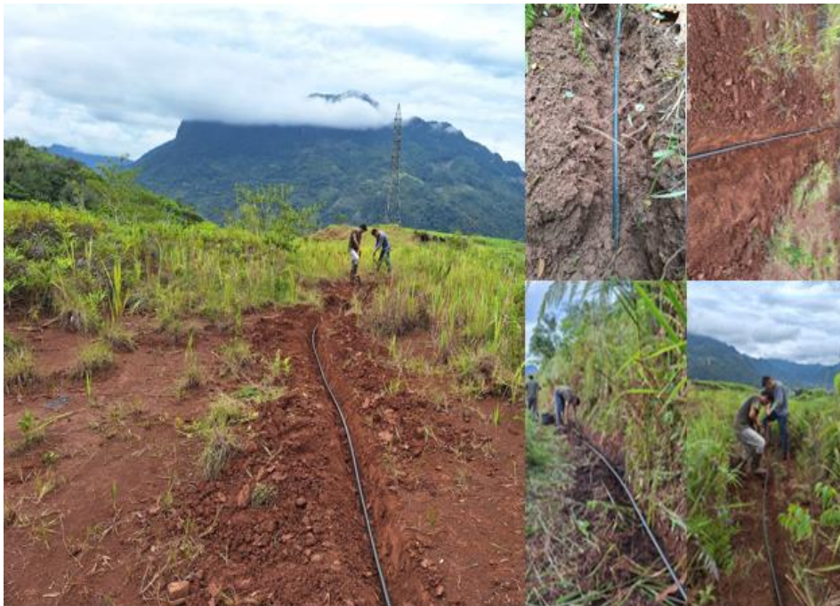
Figura 28. Instalación de 500 metros de manguera polietileno hacia la plantación de I. edulis
