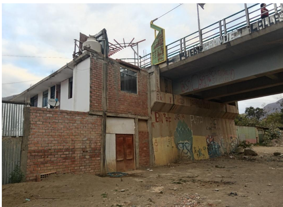
Figura 111. Viviendas construidas al costado del puente “Colpa Alta”
