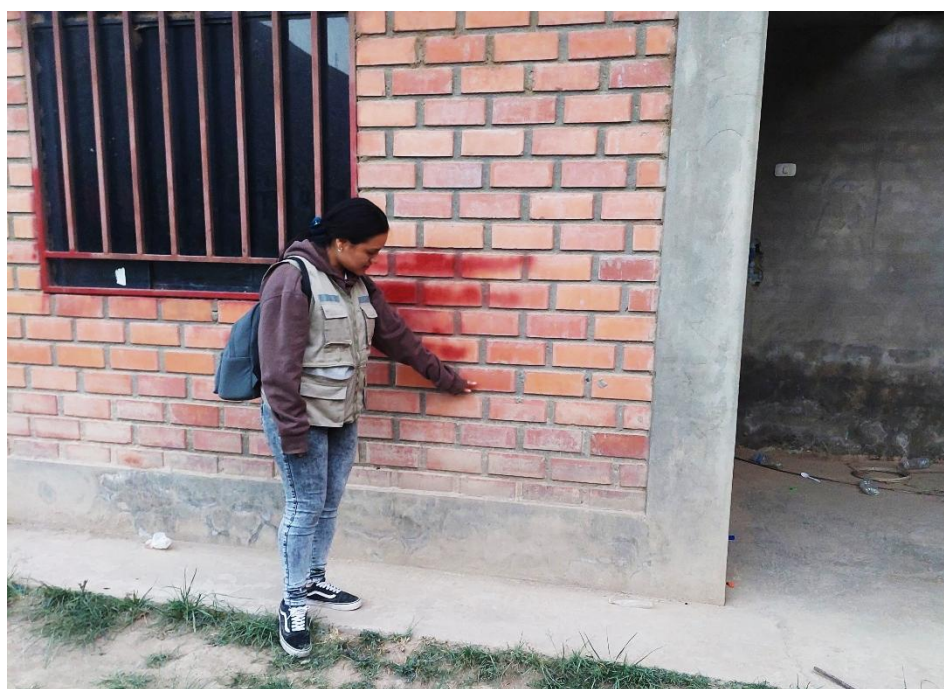
Figura 117. Marcas del nivel de agua alcanzado por el río Huallaga en Colpa Alta
