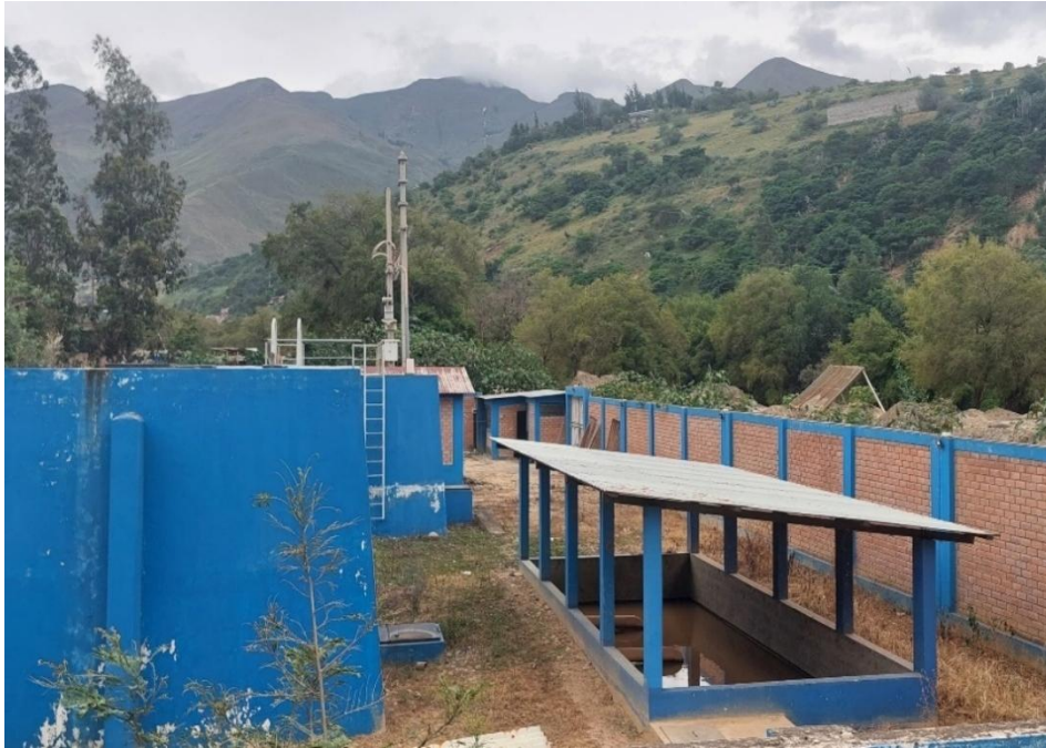
Figura 43. PTAR en el centro poblado Colpa Alta
