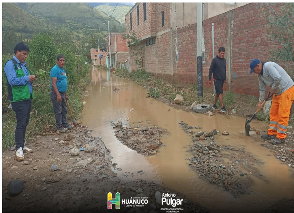
Figura 120. Desborde del río en Colpa Alta, evidenciándose el nivel alcanzado por el agua
