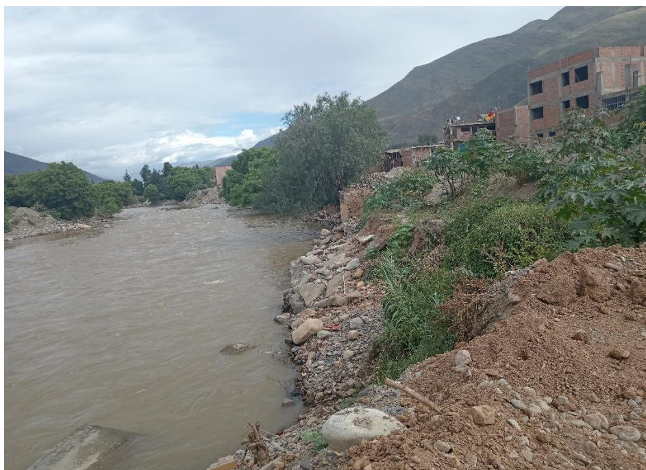
Figura 125. Tramo crítico de inundación en Yanag, con presencia de material suelto
