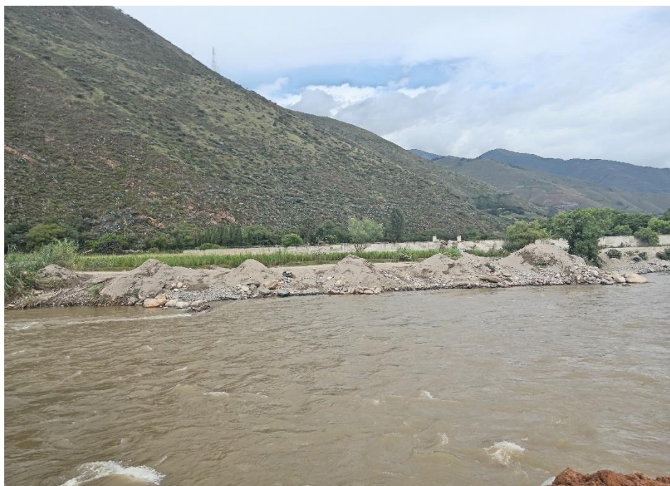
Figura 124. Acumulación de sedimentos y material de cantera en los márgenes del río Huallaga
