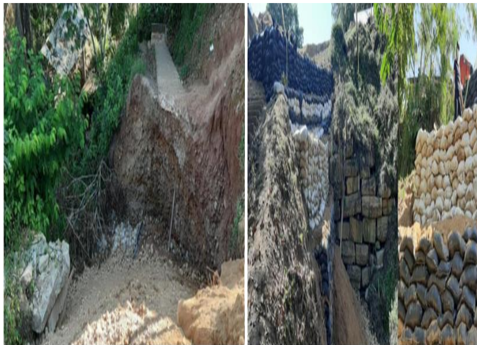
Figura 38. Deslizamiento y atención de la emergencia en la J.V. Dos de Mayo distrito de Puerto Inca código sinpad 139158.
