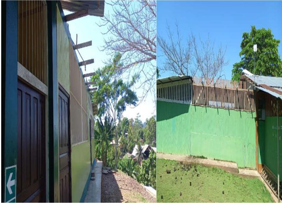
Figura 41. Afectación del techo por temporales (vientos con lluvias) a la I.E. N°155, de nivel Inicial-Jardín en el C.P. Puerto Sungaro
