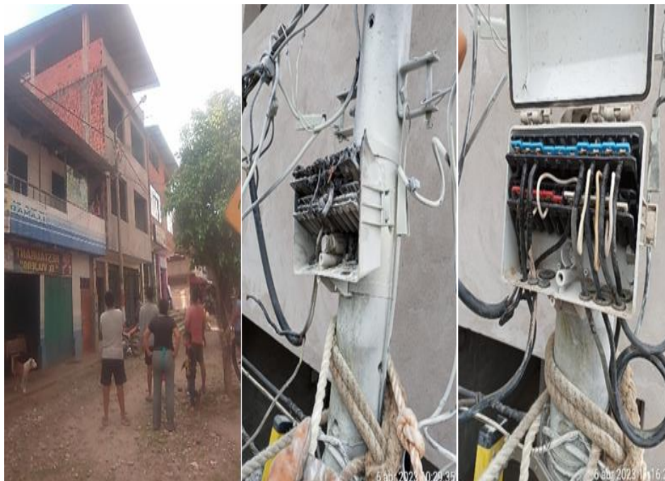
Figura 44. Afectación por incendio urbano a la caja de conexiones eléctricas del poste de luz y la atención del incidente en el C.P. Puerto Sungaro.
