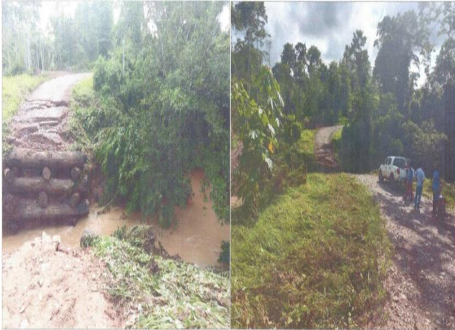
Figura 35. Lluvias intensas que ocasiono el colapso de puente forestal en la localidad Héroes del Oriente codigo sinpad 132275.
