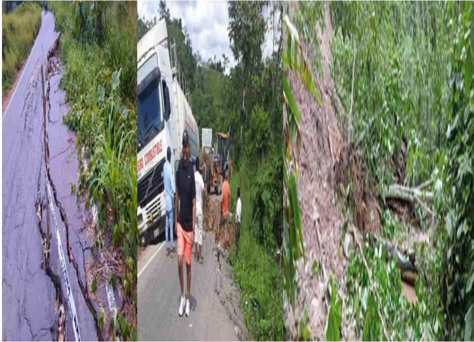
Figura 47. Deslizamiento de un tramo Puerto Inca-Puerto Sungaro y tres tramos de Puerto Inca-Paujil y la atención con intervención de maquinaria pesada.
