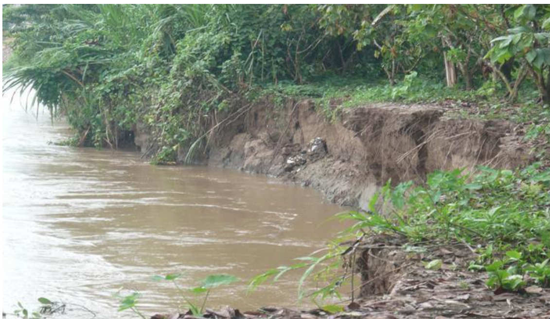
Figura 28. Vista fotográfica donde se observa la socavación producto de la erosión de suelos por la avenida del río Huallaga en épocas de invierno.
