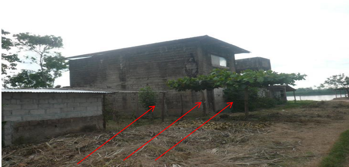
Figura 25. Vista fotográfica de casas en una de las calles ubicadas cerca al río donde se observa el deterioro de estas debido a las inundaciones que se dan anualmente.
