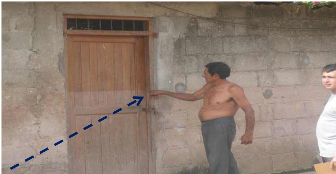
Figura 21. Vista fotográfica de la fachada de una casa donde el propietario nos indica el nivel del agua producto del desborde del rio Huallaga el año pasado.
