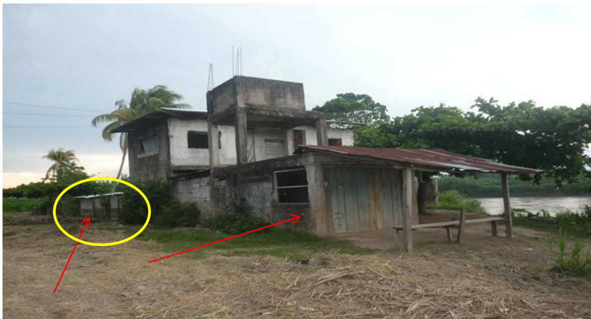
Figura 23. Vista fotográfica de casas en una de las calles ubicadas cerca al río donde se observa el deterioro de estas debido a las inundaciones que se dan anualmente.
