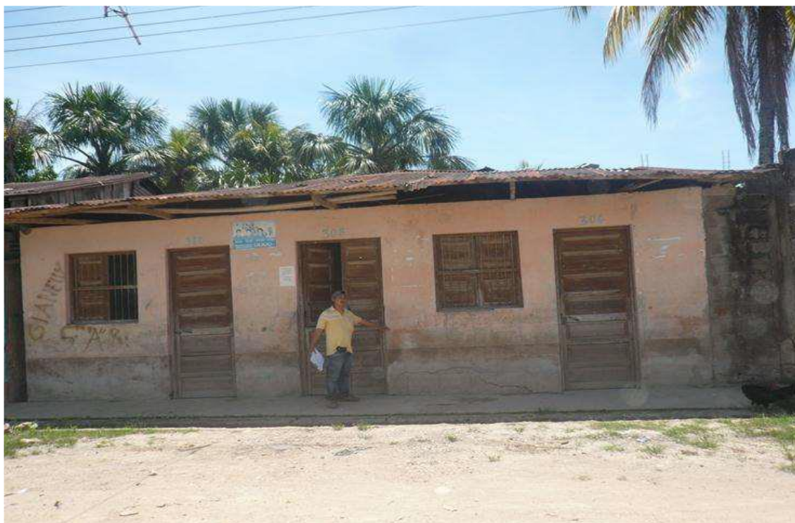
Figura 22. Vista fotográfica de la fachada de una casa donde se observa la huella del nivel donde llego el desborde del rio Huallaga que se da anualmente.
