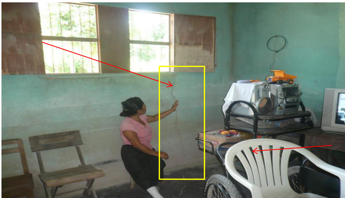
Figura 24. Vista del interior de una casa donde se observa el nivel del agua por el desborde del río Huallaga que se da anualmente y la rotura de las paredes.
