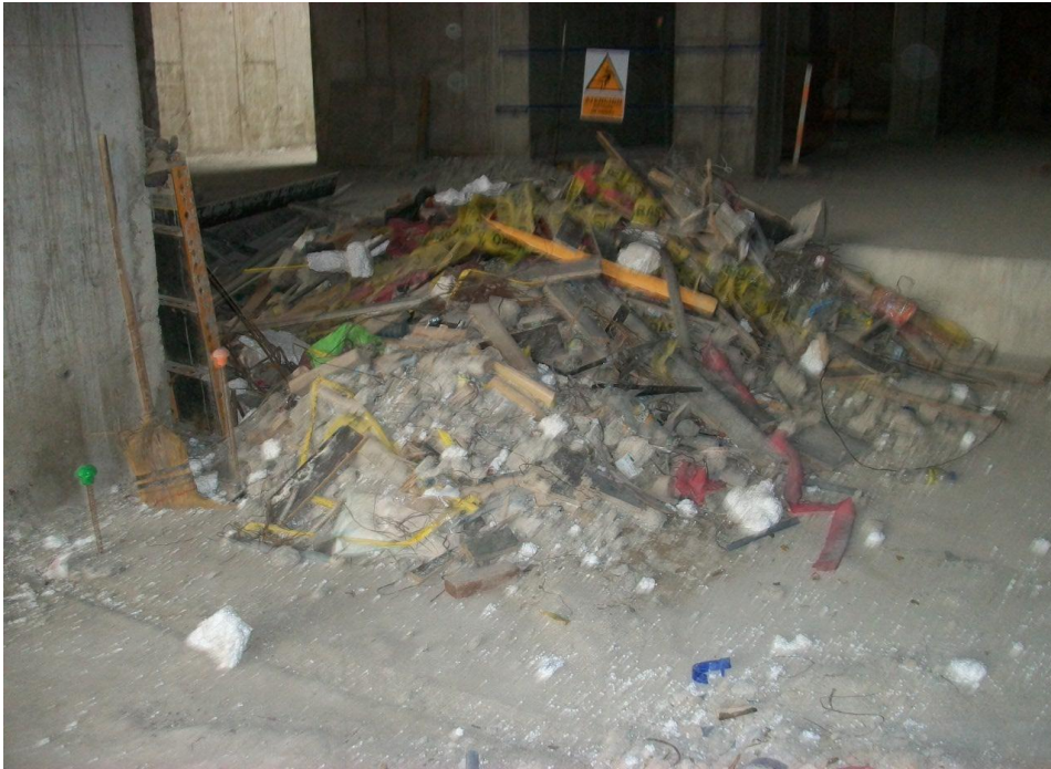
Figura 8. Disposición inadecuada de residuos de construcción civil.
