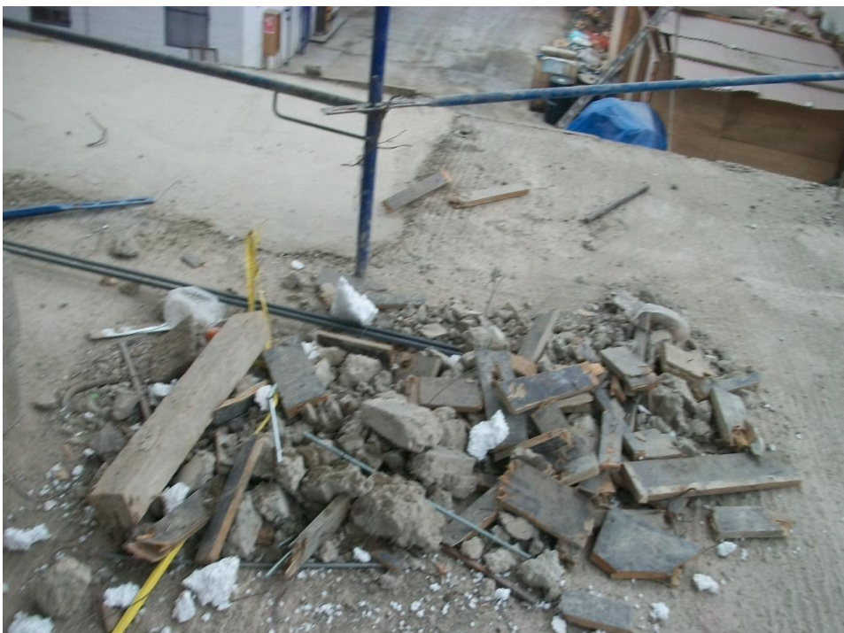
Figura 9. Disposición inadecuada de residuos de construcción civil.
