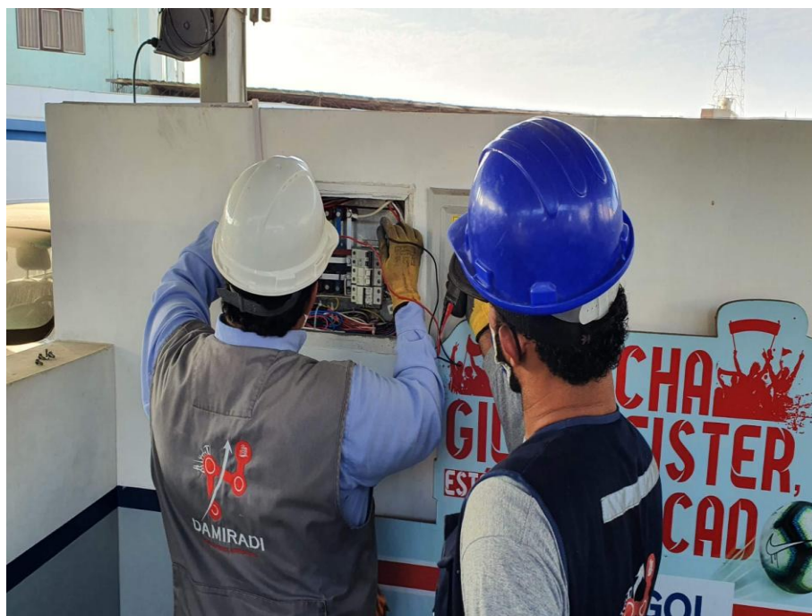
Figura 21. Monitoreo de abastecimiento eléctrico
