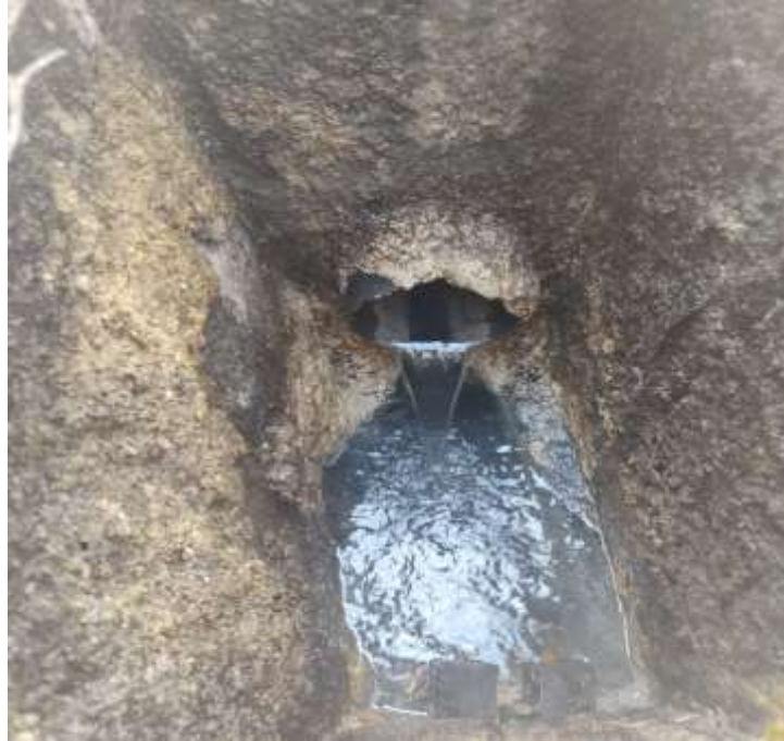
Figura 14. Punto de descarga común de aguas grises
