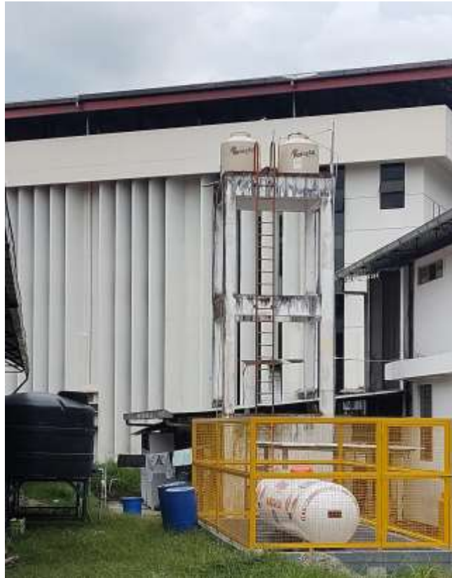
Figura 38. Área de almacenamiento de agua para abastecimiento al comedor
