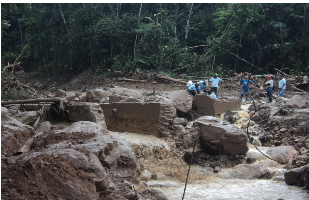
Figura 98. Colapso y pérdida total de la infraestructura de captación en la quebrada Mishqiyacu ocasionado por un huayco, 15 de noviembre del año 2014
