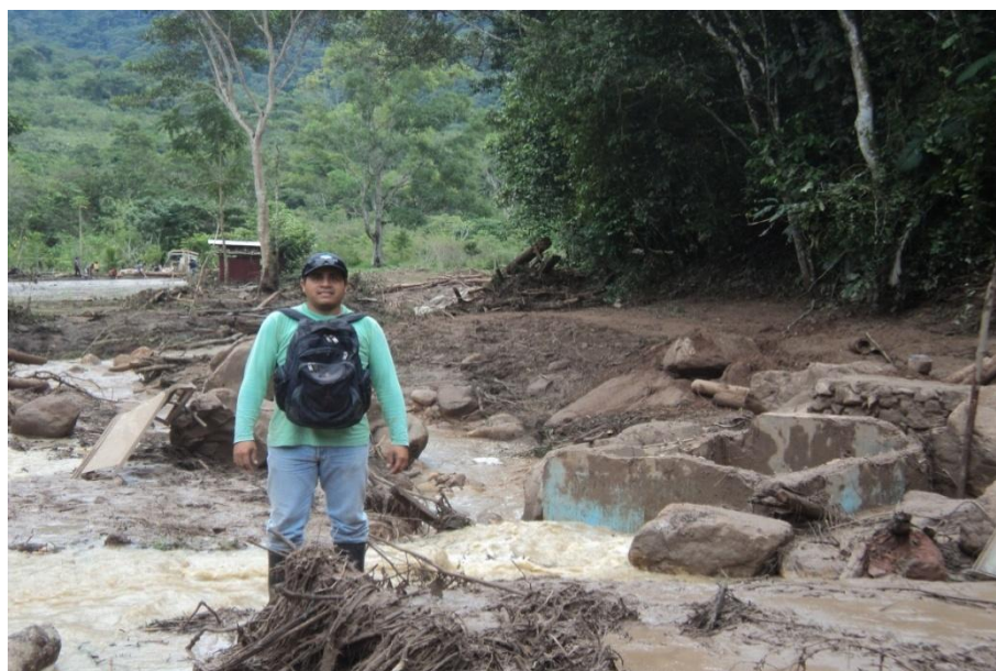
Figura 99. Evaluación de daños tras el colapso de la infraestructura de captación de la quebrada Mishquiyacu, 15 de noviembre del 2014
