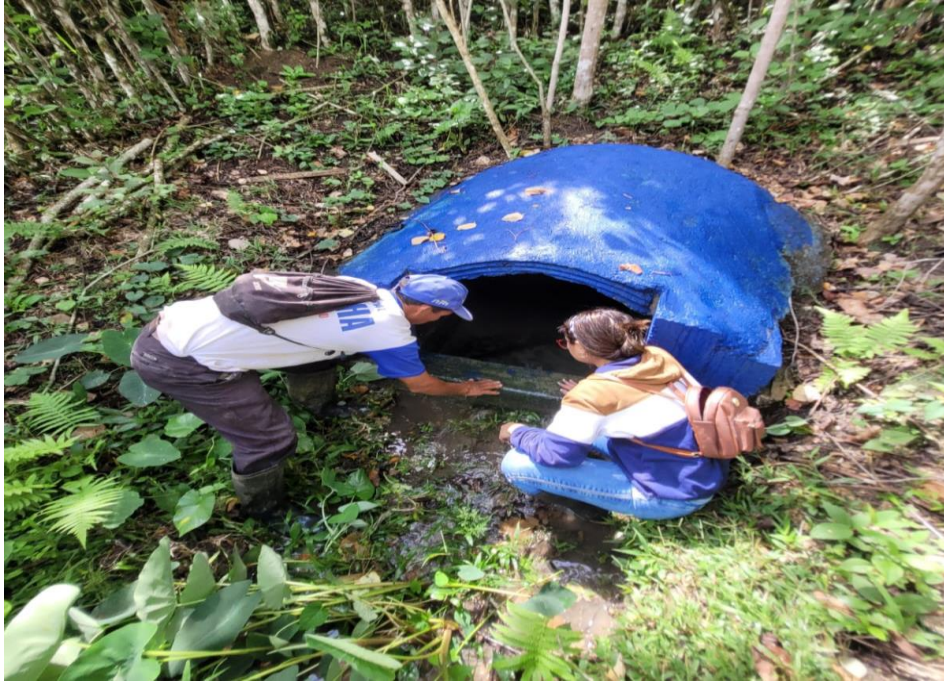
Figura 10. Identificación de la captación del sistema de agua potable
