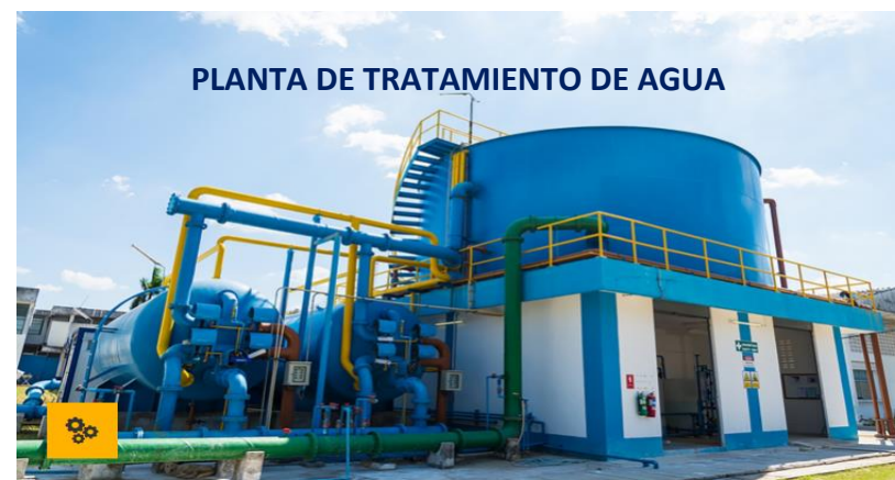
Figura 15: Planta de tratamiento
