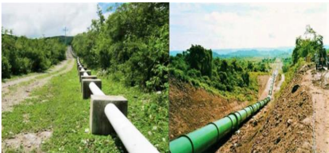
Figura 7: Tuberías de acuerdo a la geografía del terreno
