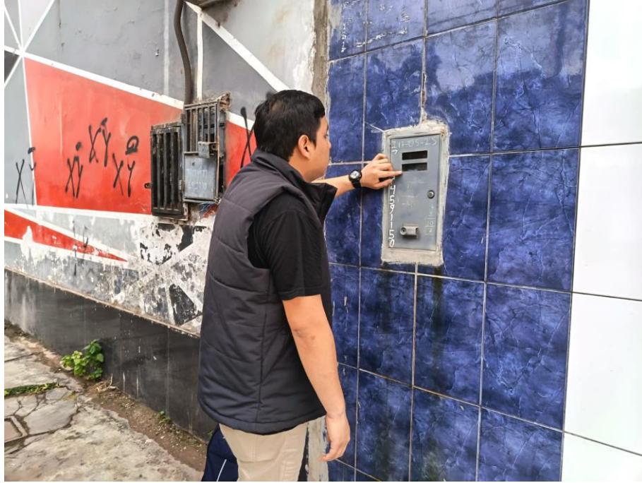
Figura 20. Verificando la caja de energía eléctrica
